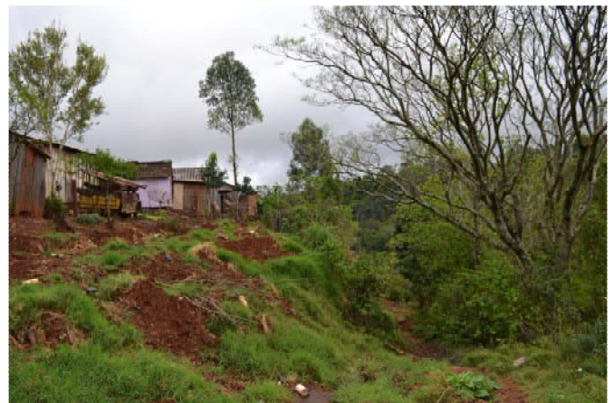
Figura 21 - Edificação em risco iminente na zona urbana consolidada do município de Belmonte/SC.
