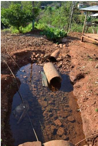
Figura 27 - Sistema de drenagem pluvial ineficiente.
